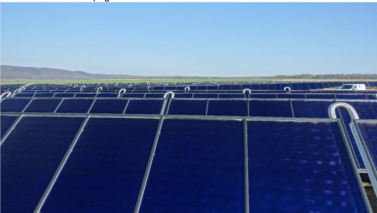
Thermische Solarkollektoren. Hier läuft das Wasser durch die Kollektoren und wird erhitzt. Dass es keine Photovoltaik ist, erkennt man an den Verbindungsschläuchen oben.
