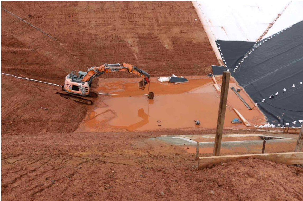
Heftige Regenfälle sorgten nicht nur für Flutung der Beckensohle, auch die ungeschützten Seitenwände wurden ausgewaschen und mussten aufwendig restauriert werden.
